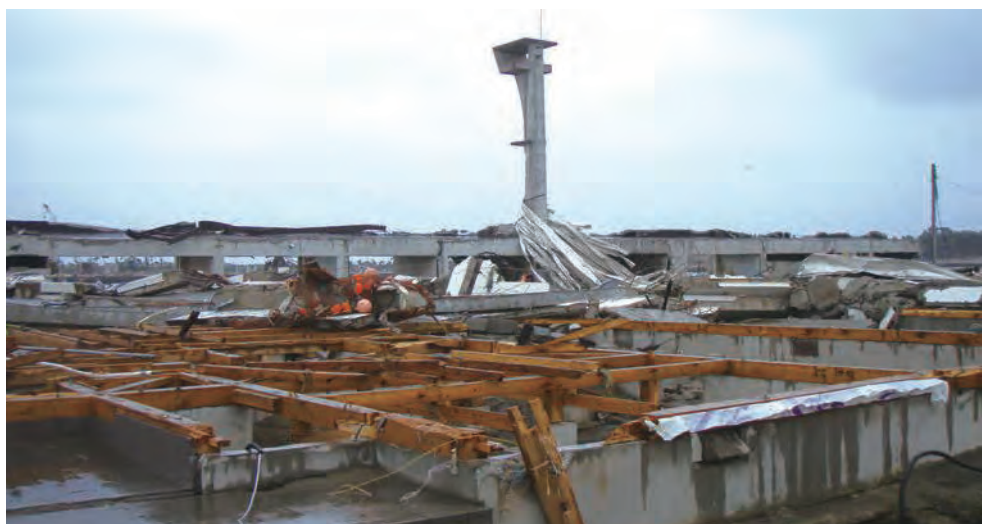
関上漁港魚市場 屋根の鉄板が津波により剥がされ漁港塔に巻き付いている。
