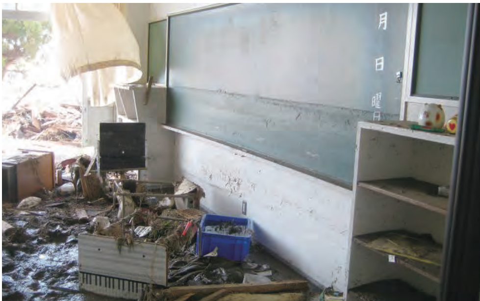
閑上中学校1階教室内 黒板に津波の跡が残る。
