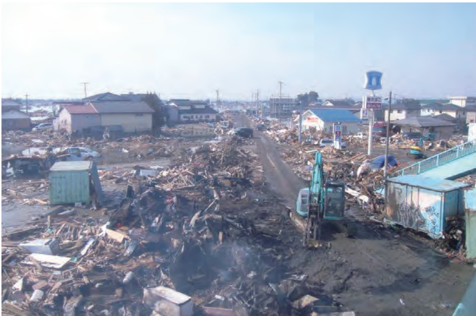
関上五叉路付近 啓開しているのは、 県道「塩釜-亘理線」。 157 平成23年3月13日 （株）ワタケン
