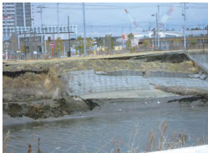
美田園 増田川堤防 土手の一部が崩落。
