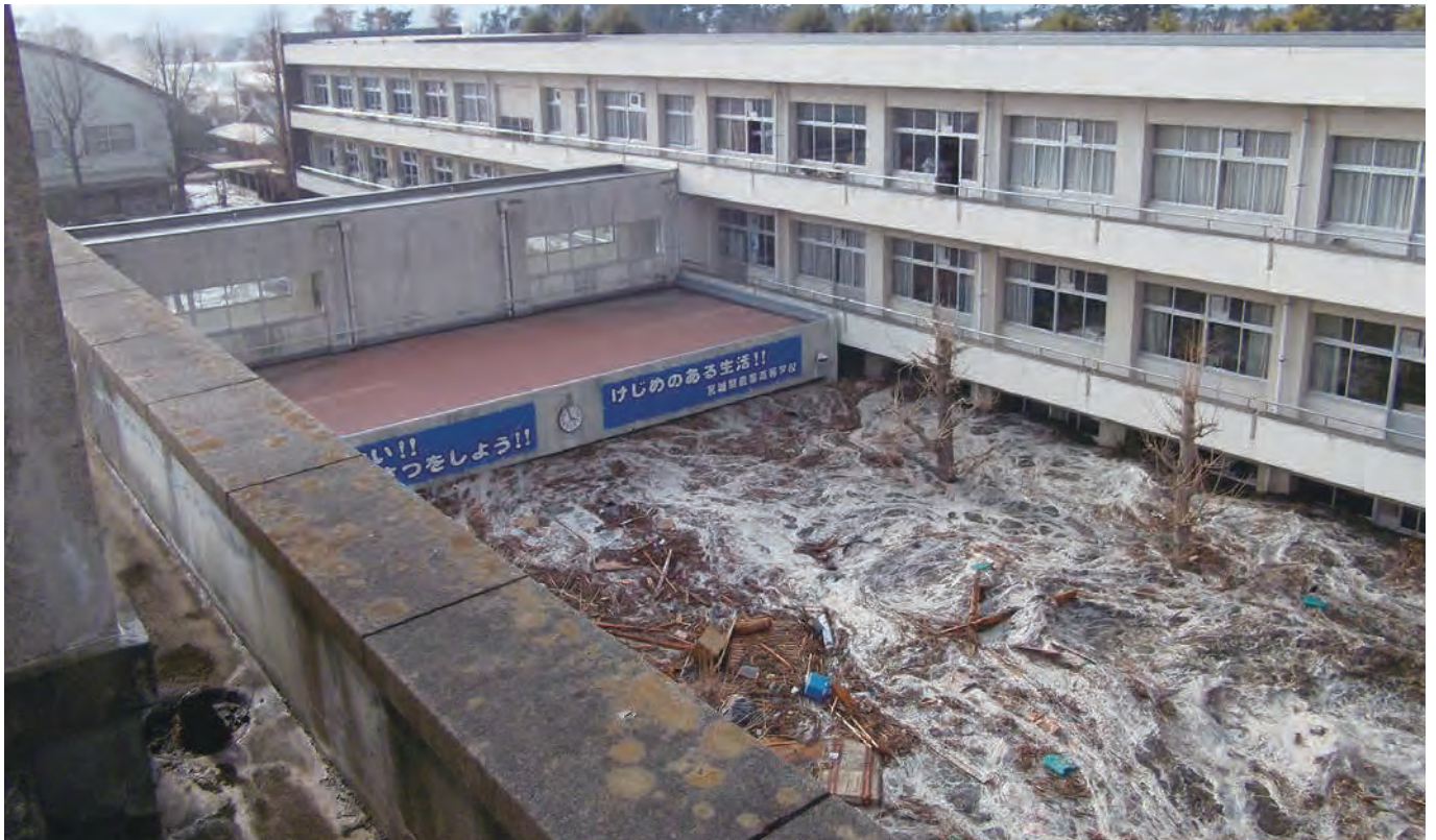
宮城県農業高等学校 校舎は使用不能となり、市の内陸部に移転した。
