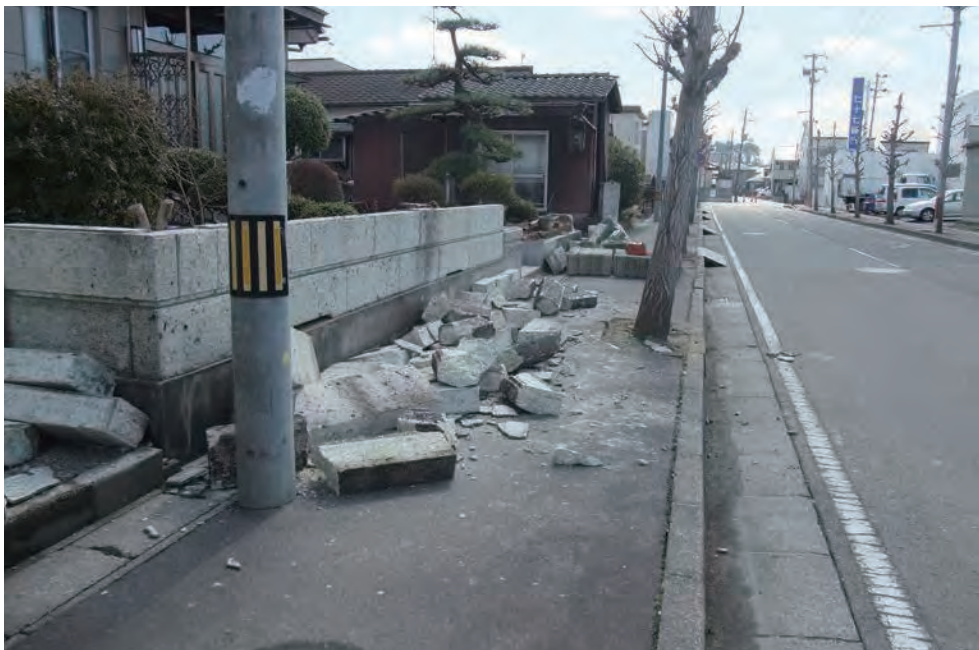
ブロック塀の倒壊
