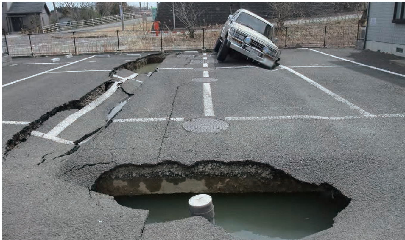
愛島塩手 表面のアスファルトを残し地盤沈下。
