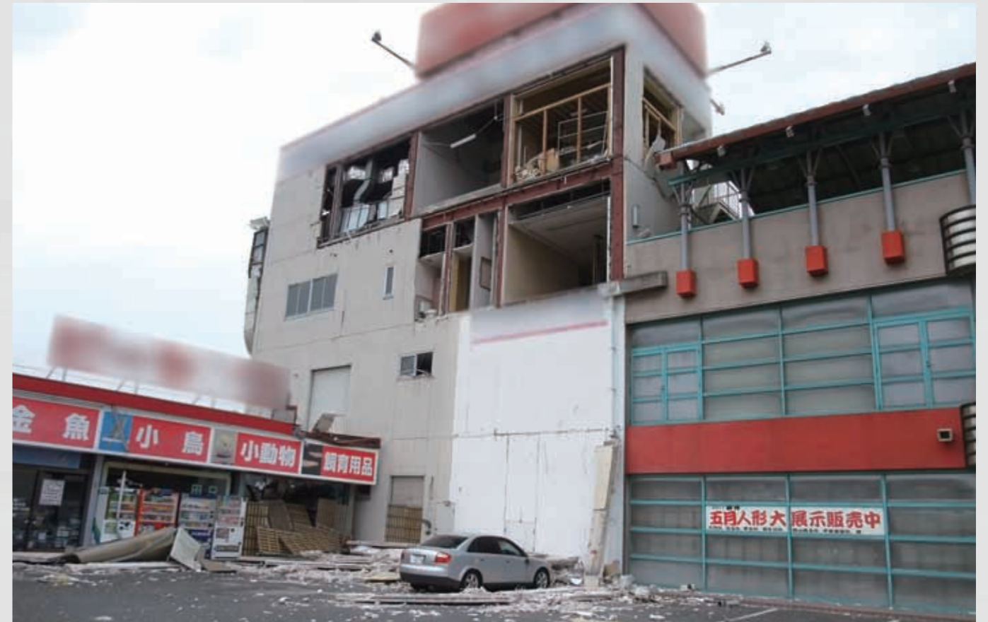
植松 地震動により被害を受けた店舗
