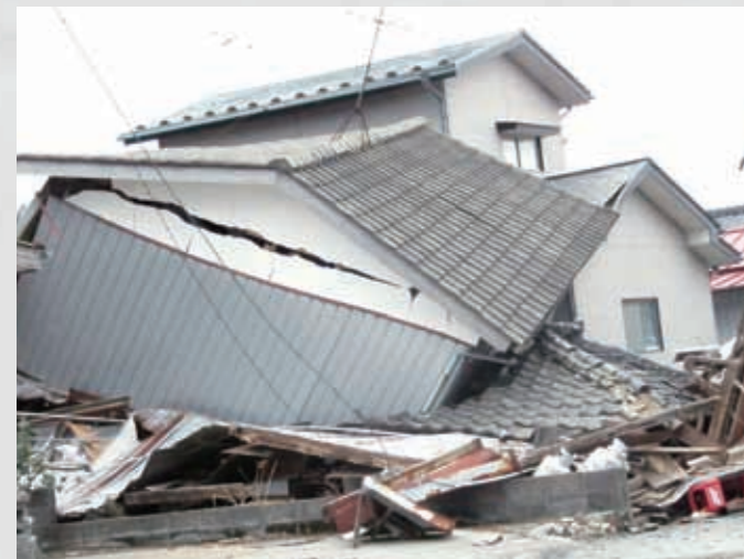
閑上の倒壊した家屋、その後津波が襲来した。
