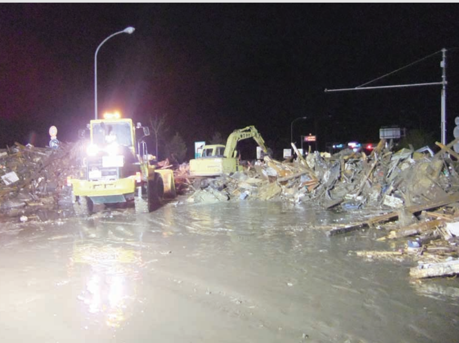
夜を徹して行われた懸命な道路啓開作業 「閉上街道」の仙台東部道路名取インターチェンジ付近。 156 平成23年3月12日 名取市
