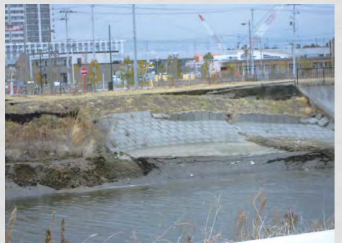
美田園 増田川堤防 土手の一部が崩落。
