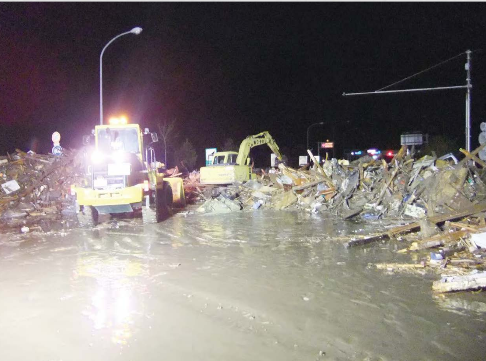
夜を徹して行われた懸命な道路啓開作業 「関上街道」の仙台東部道路名取インターチェンジ付近。 153 平成23年3月12日 名取市
