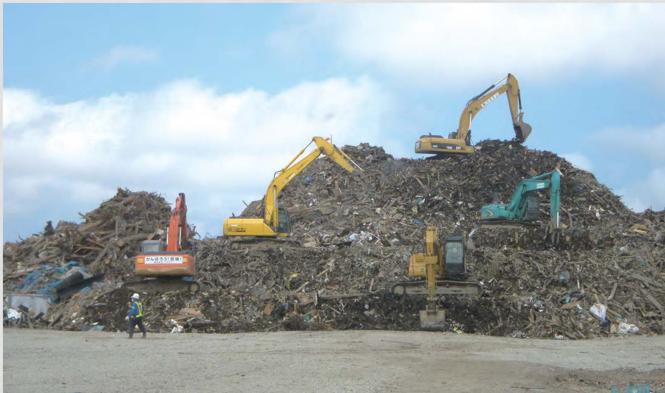
積み上げられた膨大な量のがれき
