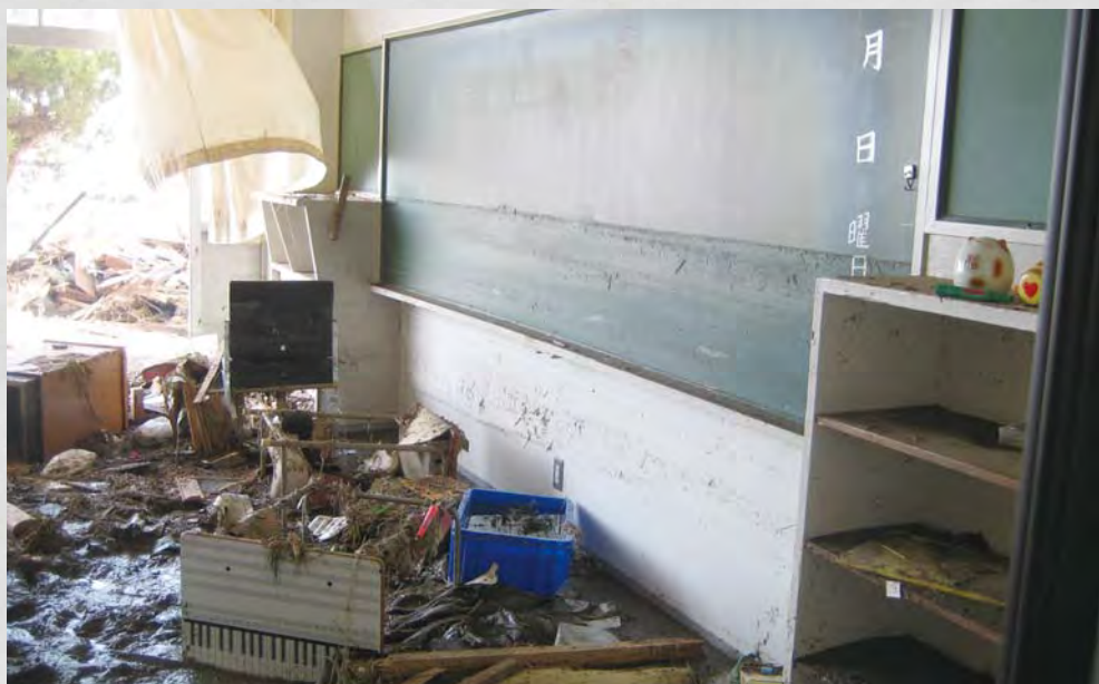
関上中学校1階教室内 黒板に津波の跡が残る。
