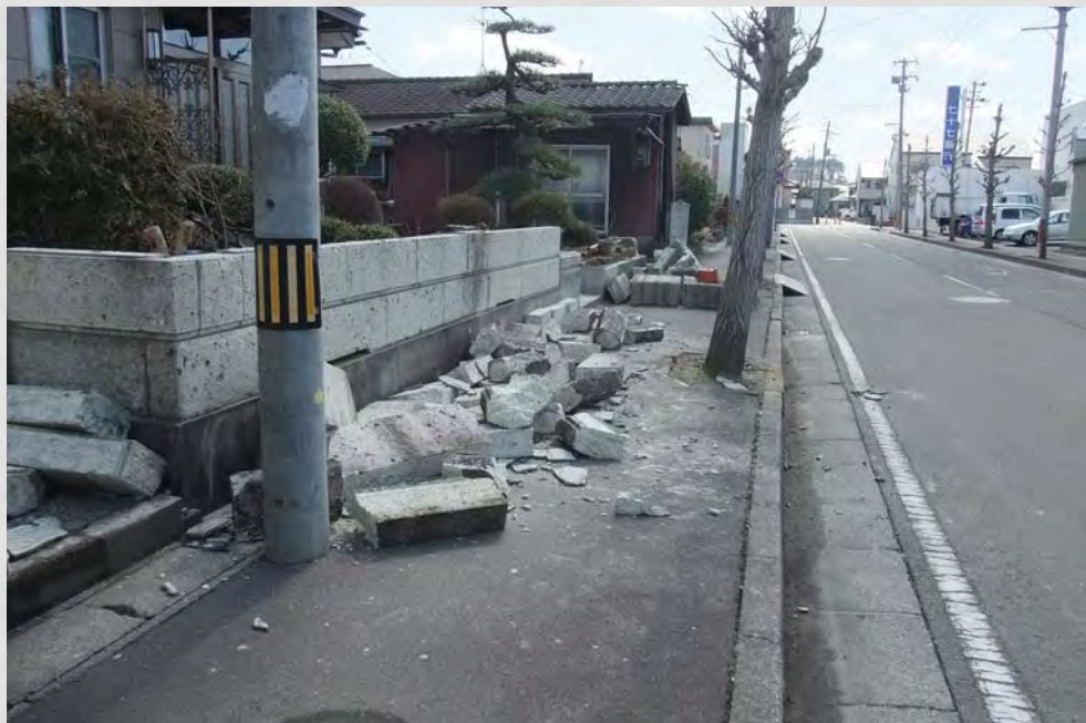
ブロック塀の倒壊
